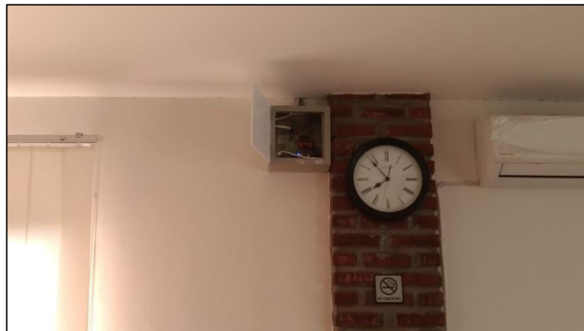
Gambar 4.4 Letak Pemasangan Mikrokontroler Lantai 3
