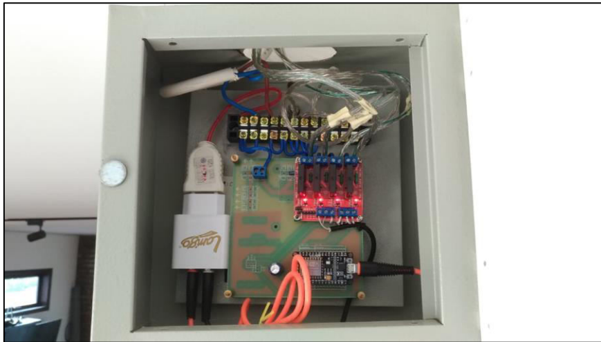
Gambar 4.5 Implementasi Mikrokontroler Pengendali Lampu Dapur
