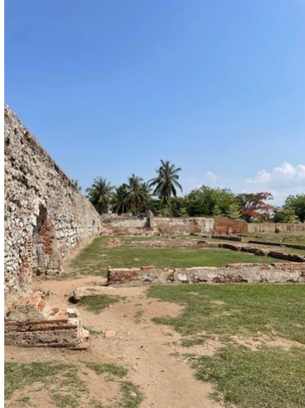
Gambar II.14 Sisa struktur pondasi bangunan Sumber: Dokumen Pribadi (3/01/2024)
