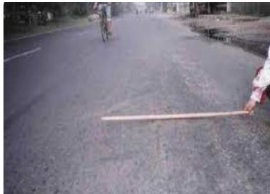
Gambar II. 14 Jembul ( Upheaval ) Sumber: Dinas PUPR Kab. Kulon Progo
