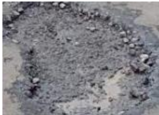
Gambar II. 16 Pelepasan Butir ( Raveling ) Sumber: Dinas PUPR Kab. Kulon Progo
