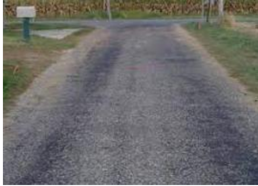
Gambar II. 19 Kegemukan ( Bleeding or Flushing ) Sumber: Dinas PUPR Kab. Kulon Progo
