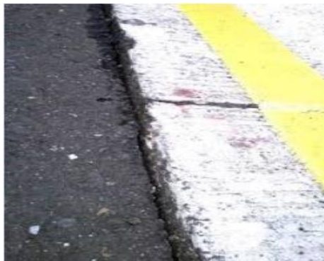
Gambar II. 6 Retak Sanbungan Pelebaran Jalan ( Widening Crack ) Sumber: Dinas PUPR Kab. Kulon Progo
