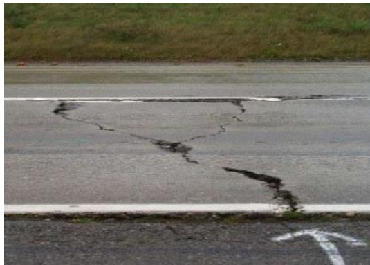
Gambar II. 4 Retak Sambungan Bahu dan Perkerasan ( Edge Joint Crack ) Sumber: Dinas PUPR Kab. Kulon Progo
