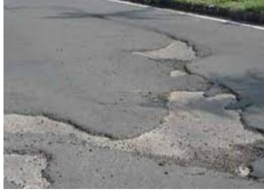
Gambar II. 17 Pengelupasan Lapisan Permukaan ( Stripping ) Sumber: Dinas PUPR Kab. Kulon Progo
