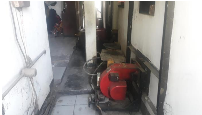
Gambar II.20 Blower Sebagai Alat Bantu Pembakaran Sumber: Dokumen pribadi (2023)
