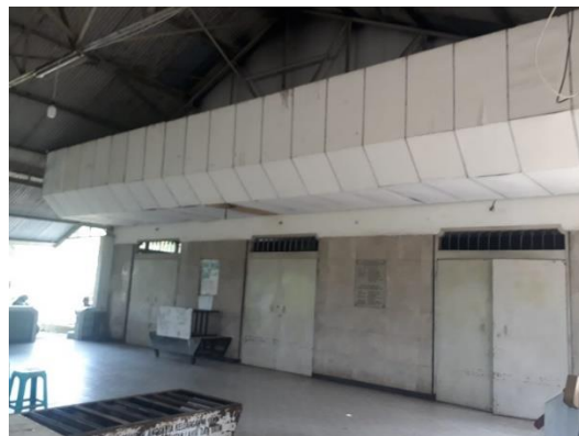
Gambar II.19 Ketiga Ruangan Oven Yayasan Krematorium Bandung Sumber: Dokumen pribadi (2023)
