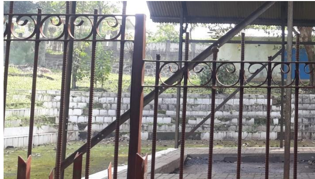
Gambar II.24 Ubin yang Rusak dan Dipenuhi Rumput Liar dan Lumut Sumber: Dokumen pribadi (2023)
