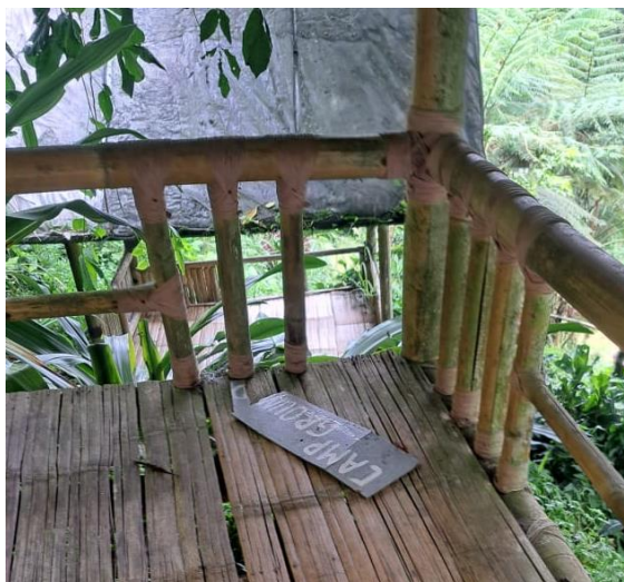
Gambar I.3 Sistem Tanda Identifikasi Yang Sudah Patah Sumber: Dokumentasi Pribadi (2022)
