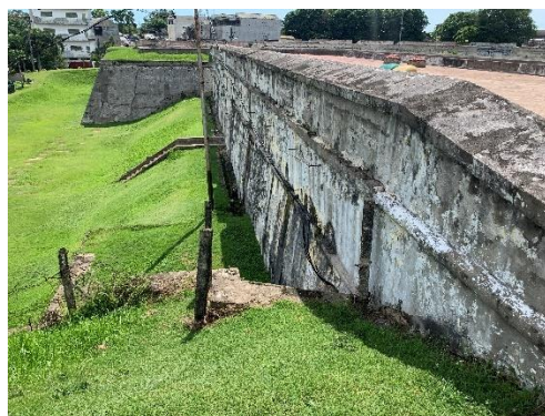
Gambar II.18 Potret Area Samping Benteng Marlborough yang Berbahaya
