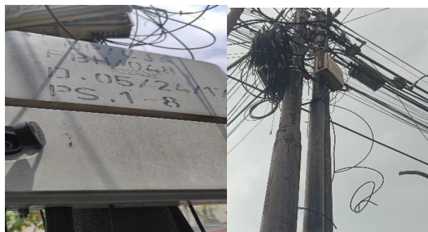
Gambar 2.3 ODP Tipe Wall atau On Pole (Sumber: PT Telkom Witel Bandung)
