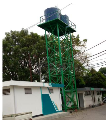
Gambar 2.24 Gardu kontroling listrik dan pusat air bersih.
