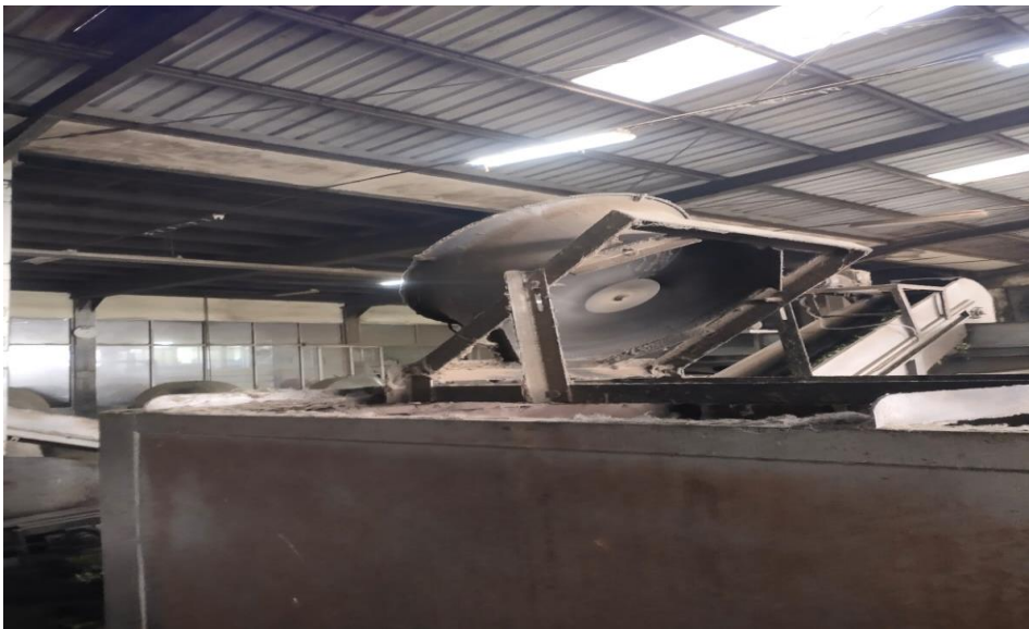
Dokumentasi 2 Blower pada Mesin Pendingin
