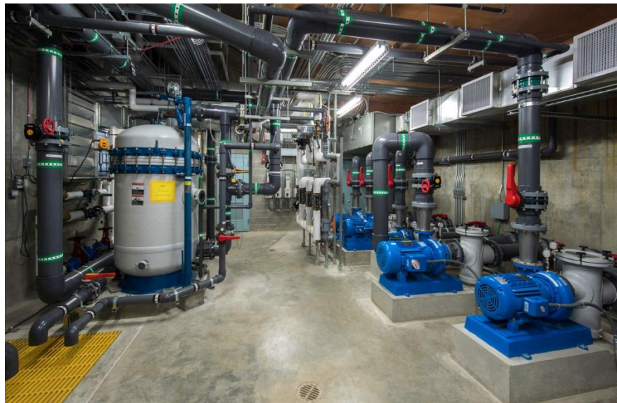
Gambar 2.18: Ruang pompa Sumber: google image
