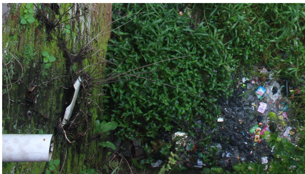
Gambar II.7. Pipa Air Pembuangan Detergen Sumber: Dokumentasi Pribadi
