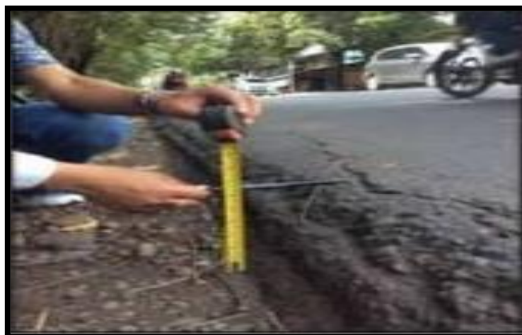
Gambar 2.10 Kerusakan Pinggiran Jalan Turun Vertikal
