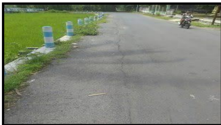
Gambar 2.8 Kerusakan Retak Samping Jalan
