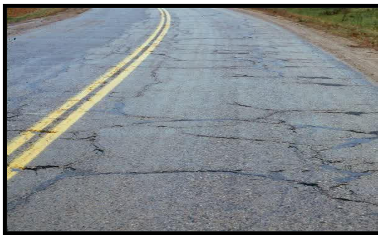
Gambar 2.18 Kerusakan Patahan Slip
