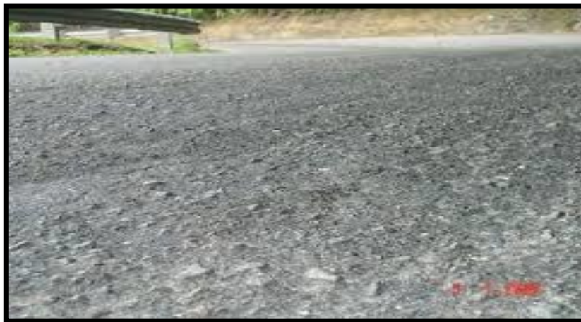
Gambar 2.20 Kerusakan Pelepasan Butir
