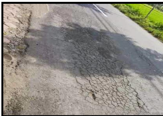
Gambar 2.2 Kerusakan Retak Kuit Buaya
