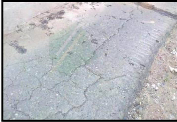
Gambar 2.9 Kerusakan Retak Sambung
