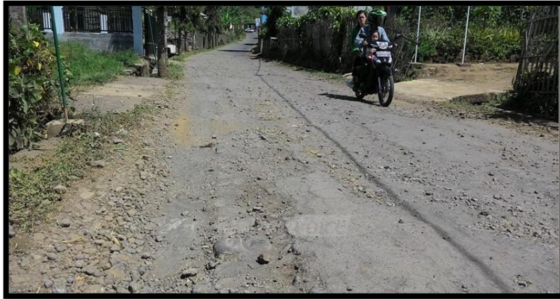
Gambar 2.19 Kerusakan Mengembang Jambul
