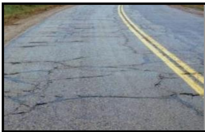
Gambar 2.4 Kerusakan Retak Kotak – Kotak
