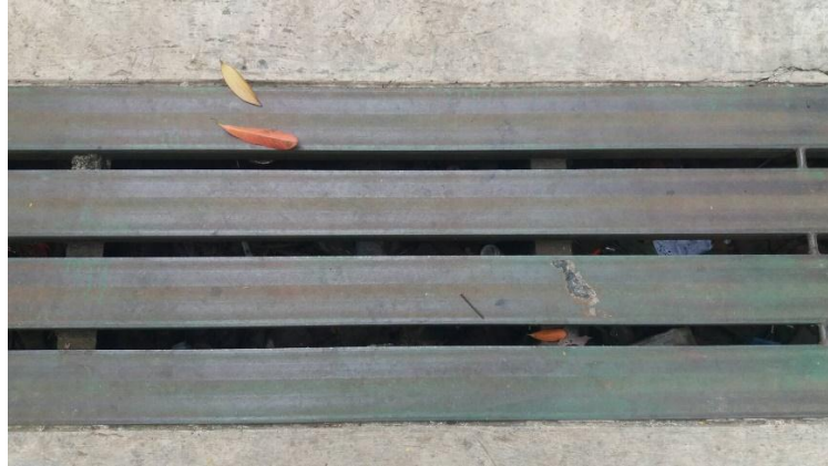
Gambar 4.11 Kondisi Drainase Sumber : Dokumen Pribadi
