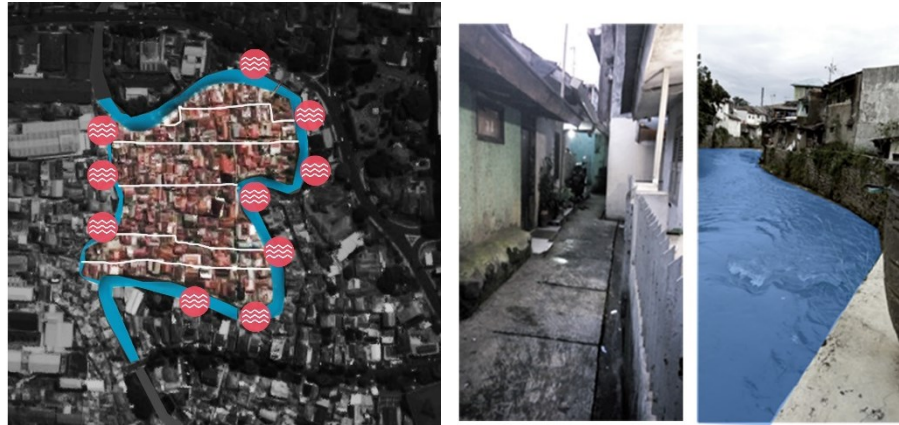
Gambar 4.19. Kondisi Drainase Kawasan Permukiman RW 03 Babakan Ciamis
